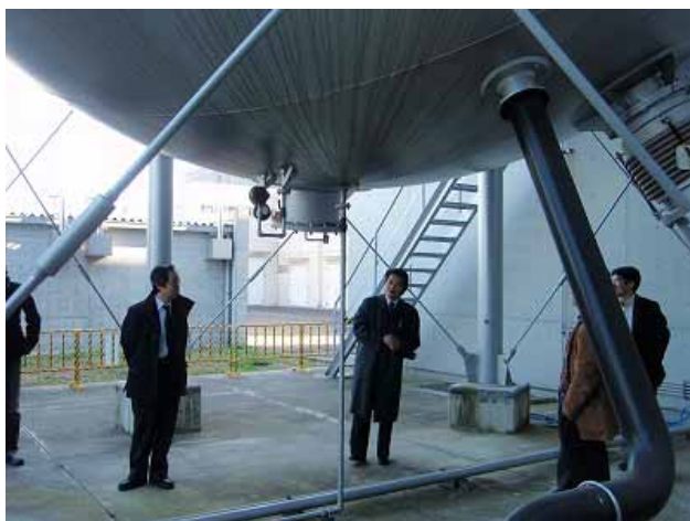
風洞下流側に接続される球形真空タンク、上流側には高圧タンクがある
